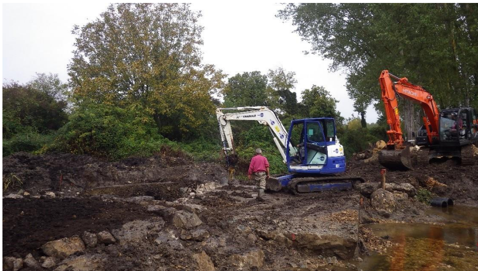
Figure 10 : Destruction du pont canal en 2019 (PNR LAT)
